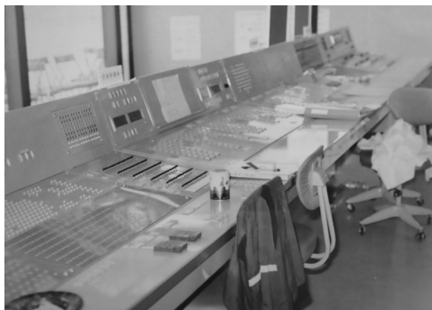
図6 コントロールルーム
